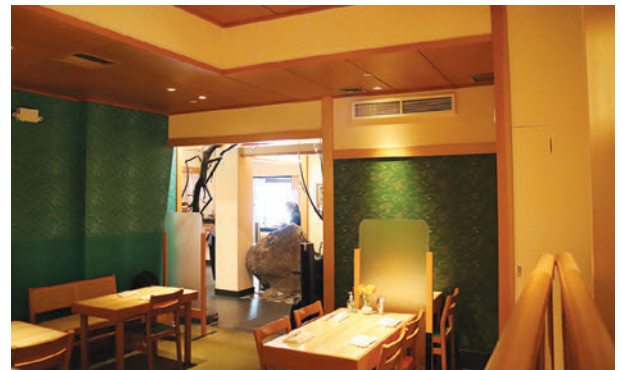
天井のスペースを活用し、客席から見えない形でエアコン設置
