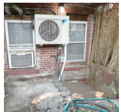
室外機を外壁に設置しバックヤードのスペースもすっきり
